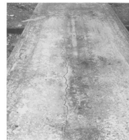
Longitudinal crack (slab)
